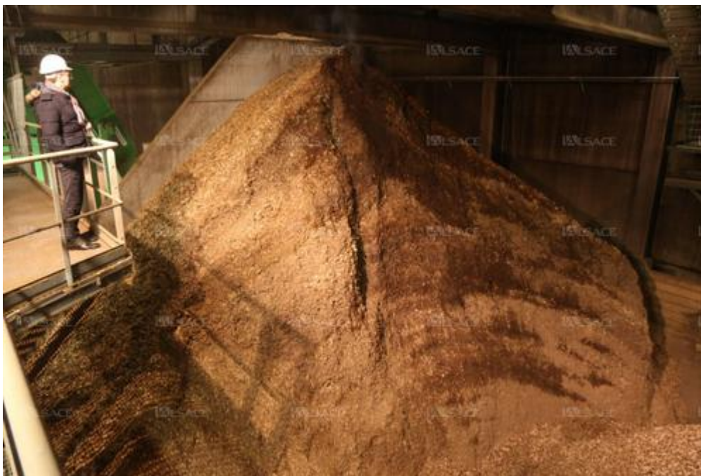
La chaufferie urbaine de Saint-Louis, la centrale à cogénération biomasse gérée par R-CUE est un solide argument dans le bilan vert de la ville. Archives DNA /Jean-Francois OTT
